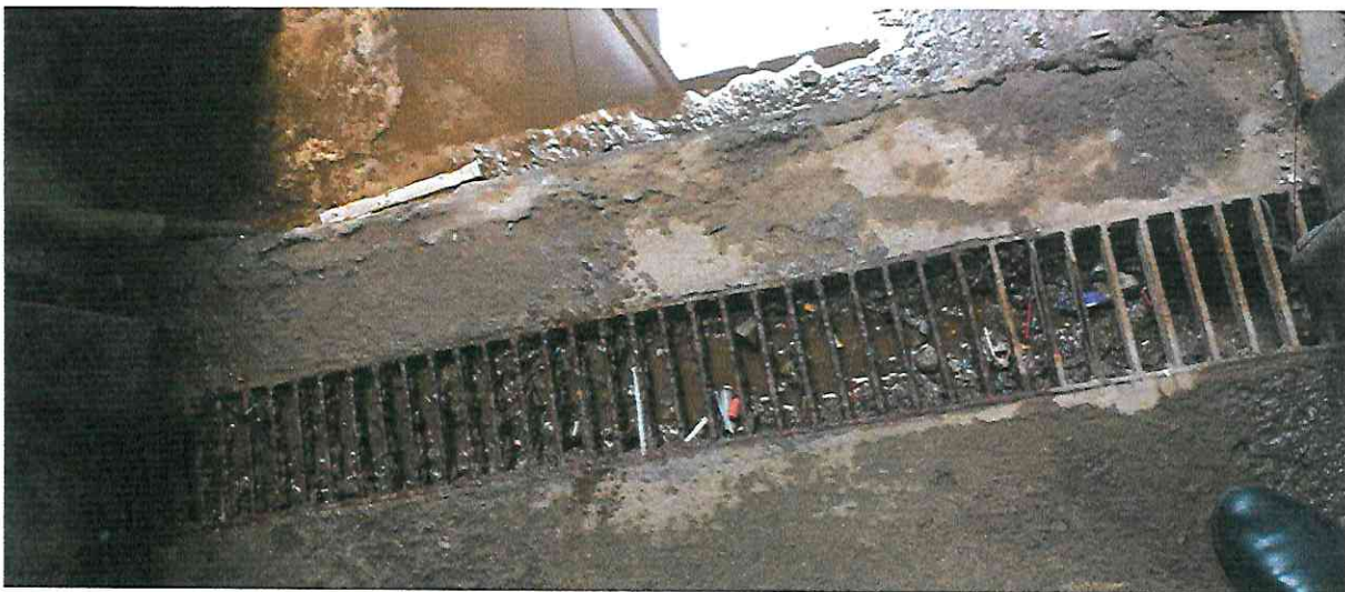
Estancamiento de agua pluvial que ocasiona lodo y por tanto obstrucción de paso en el elevador
