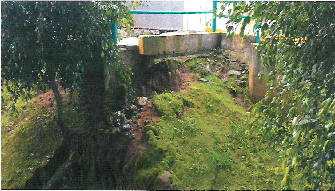
Estancamiento de lodo que ocasiona el tapado de alcantarillas.
